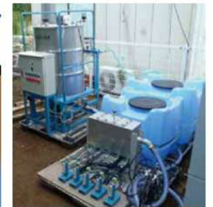
簡易薬液注入装置
