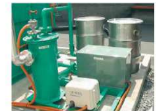
土壌ガス吸引装置
