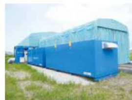
ガス回収装置
